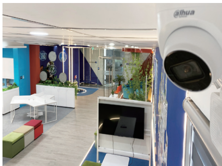
監視カメラによる常時モニタリング
